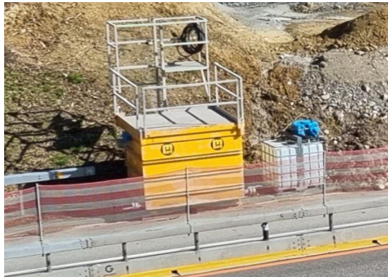
Abb. 60 Beispiel Absetzbecken: Vorgesehen während der Bauphase der PVA
