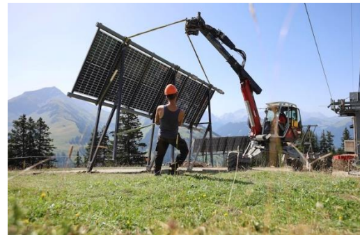
Abb. 49 Einsatz des Menzi Muck bei der Testanlage in Saanenmöser (SolSarine 2023) (Foto: Jungfrau Zeitung, 01.09.2023)
